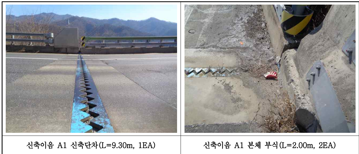
【사진 1.3.17】 신축이음장치 손상현황(계속)
