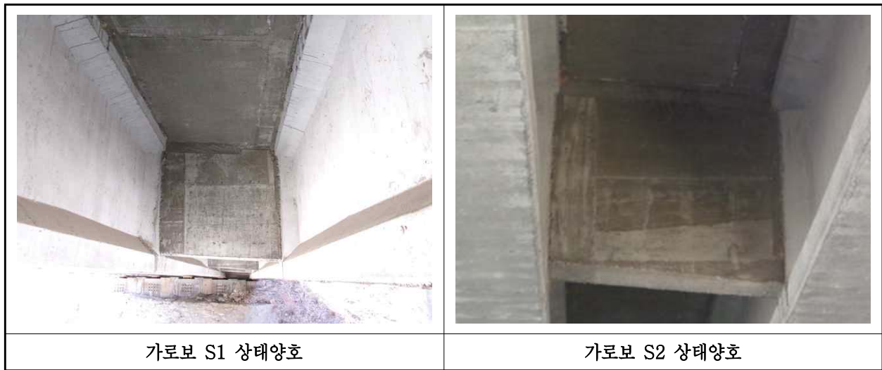
【사진 1.3.7】 가로보 손상현황
